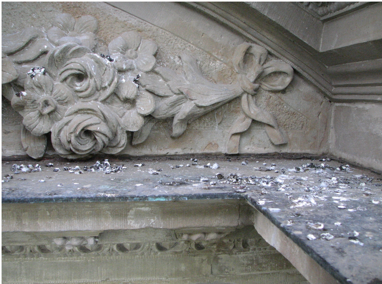
Abb. 6: Verunreinigungen durch Taubenkot
