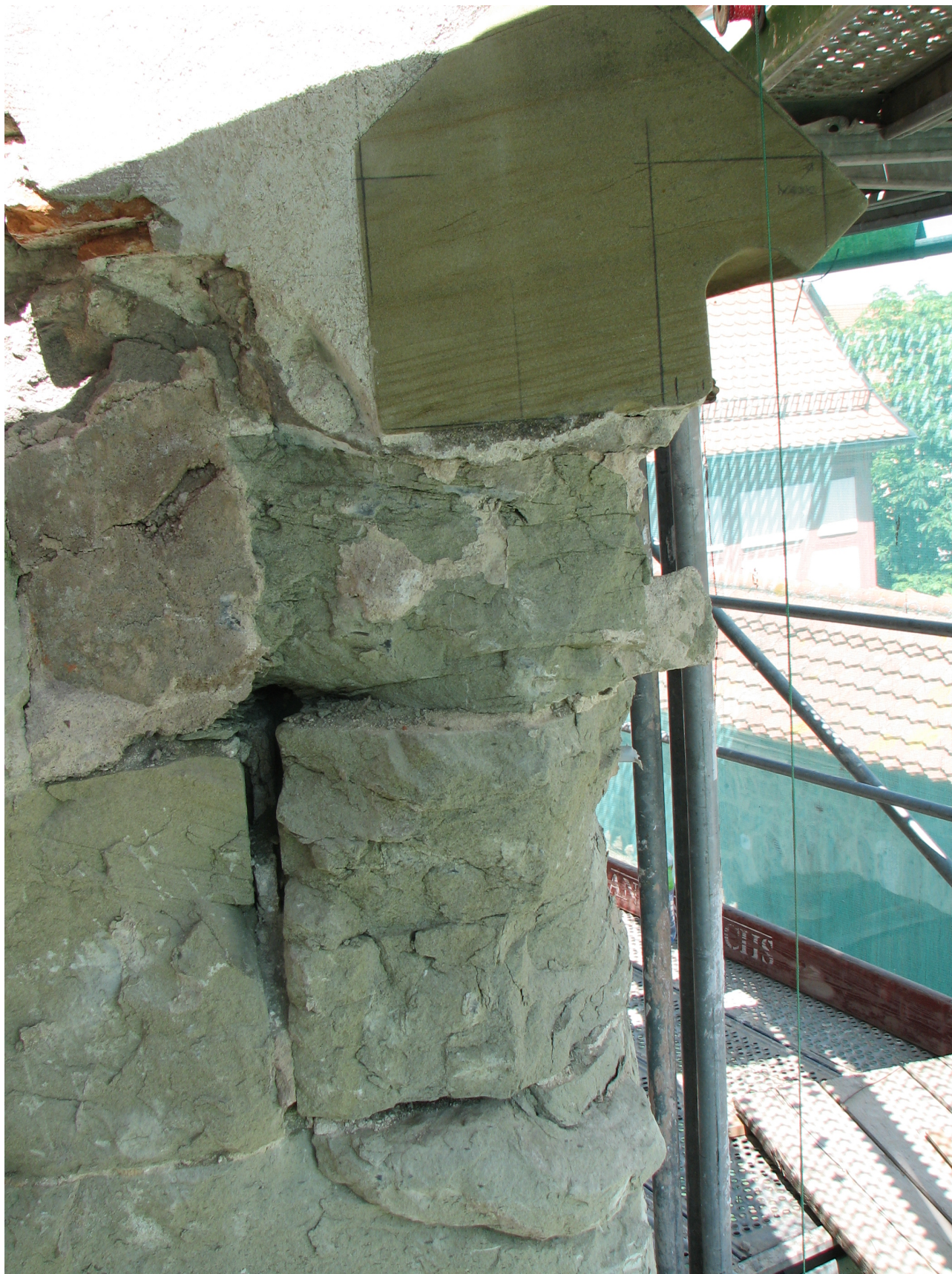
Abb. 2: Rechter Pfeiler (P2) nach Abnahme der Putzschicht
